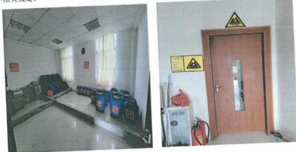
图 3-4 危险废物暂存间
