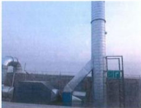
废气处理设施照片
