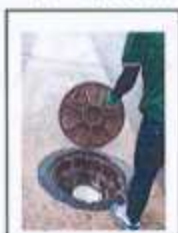
生活污水排放口
