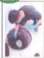
生活污水排放口
