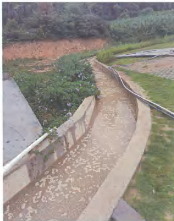
填埋场内截洪沟下游雨水汇集处
