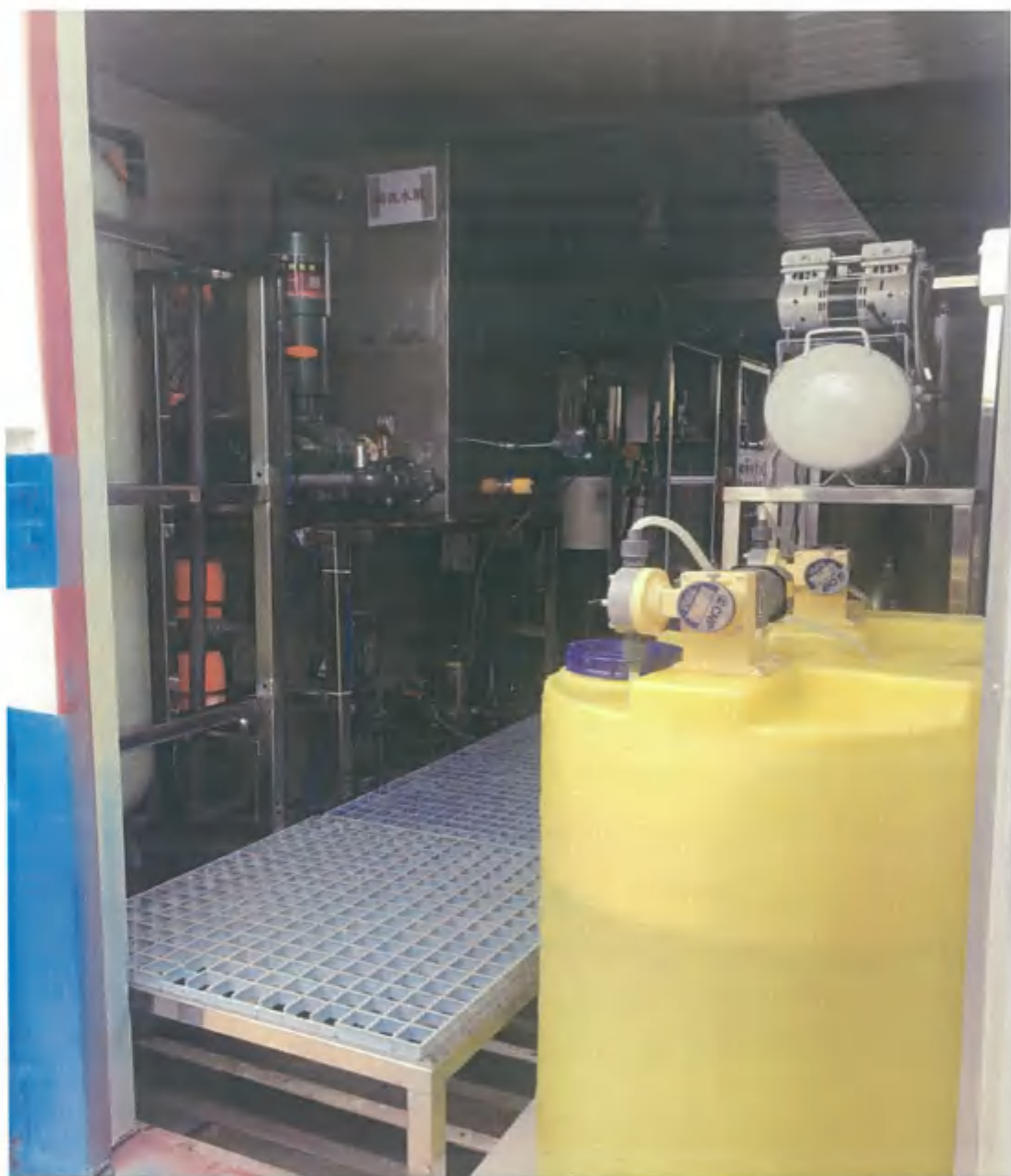
图 3-35 渗滤液处理设施图
