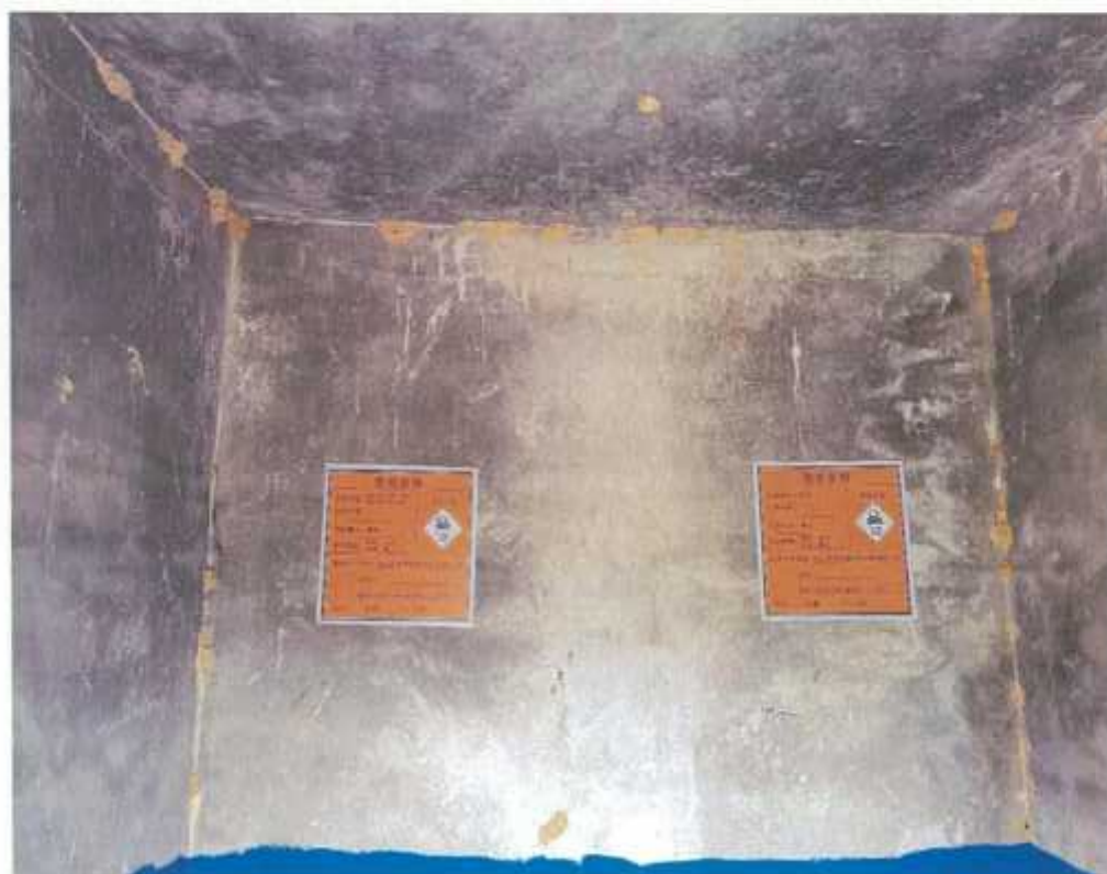
图 8-4 危废房内部设置
