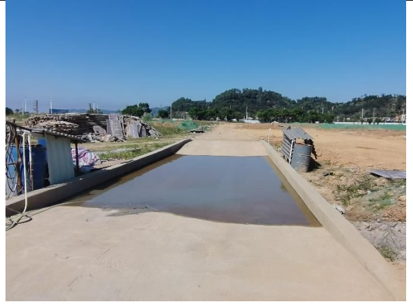
项目洗车槽（依托页岩砌块 B 区生产项目）
