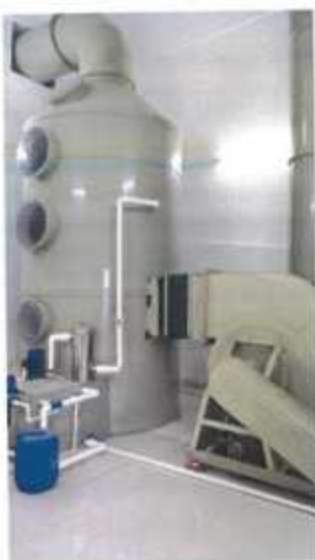
图 3-3 垃圾停放、倾倒、压缩和运输过程废气治理设施图
