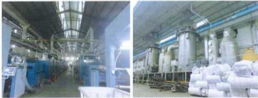
定型机和定型、燃天然气废气处理设备
