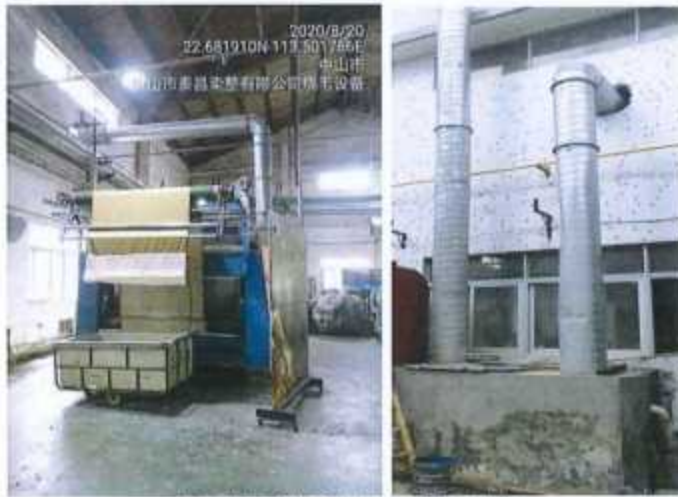
烧毛设备和烧毛废气处理水喷淋塔
