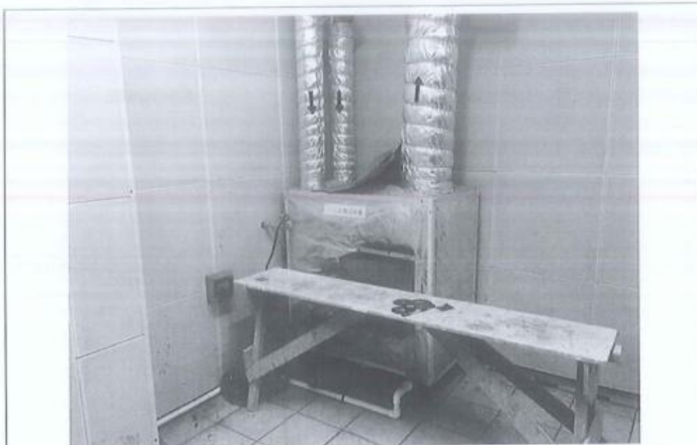
图 3-3 备用发电机尾气治理设施图
