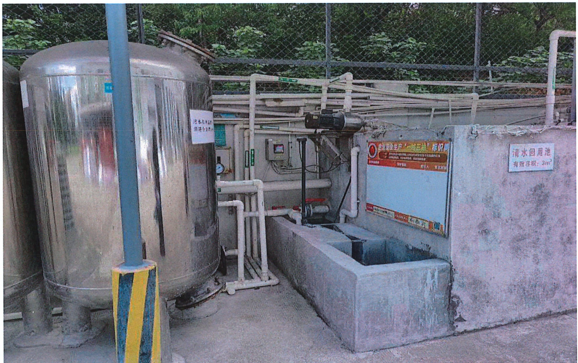
图 3.3 污水处理设施
