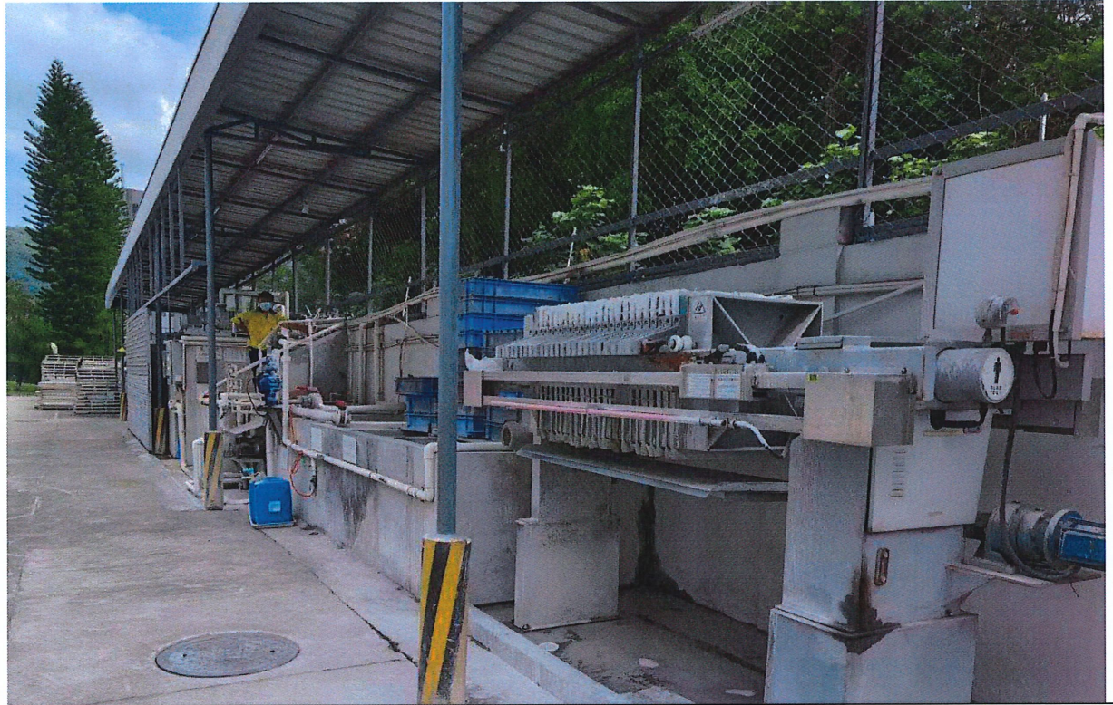
图 3.2 污水处理设施
