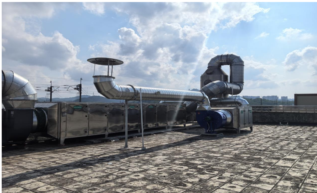
附图 3：废气治理设施图片
