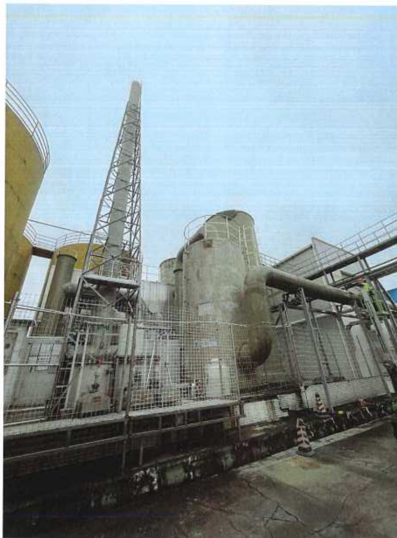
附图 3：废气治理设施图片
