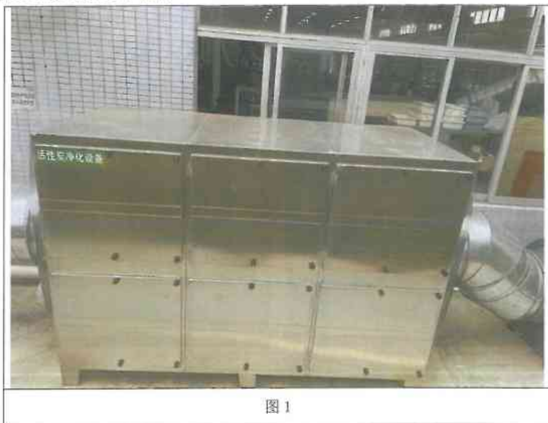
附图 3：废气治理设施照片
