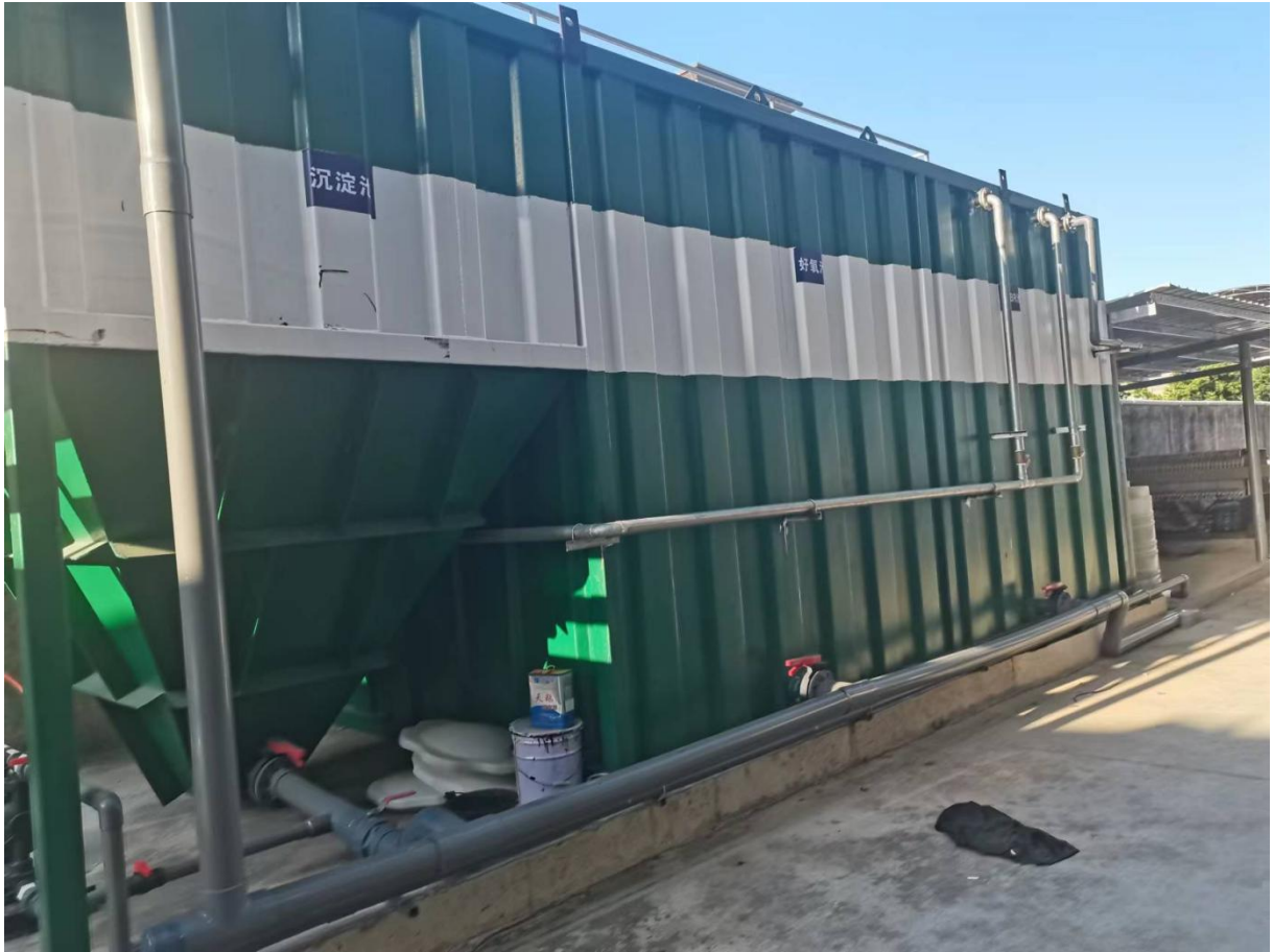
一体化污水处理设施
