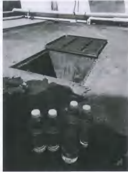
综合废水排放口
