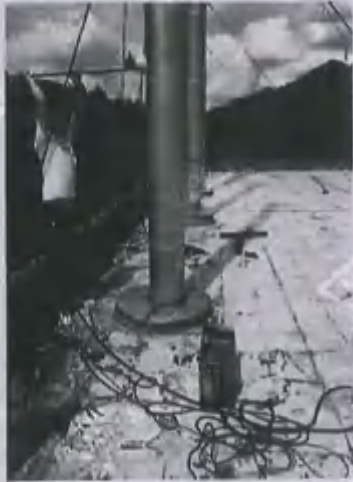
燃天然气1#锅炉排气筒
