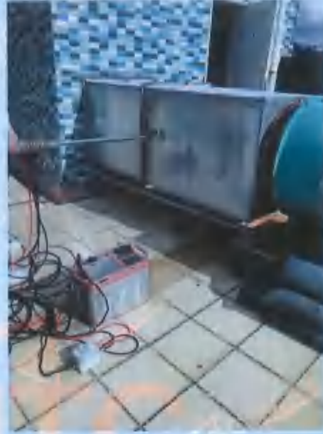
发电机废气排气筒
