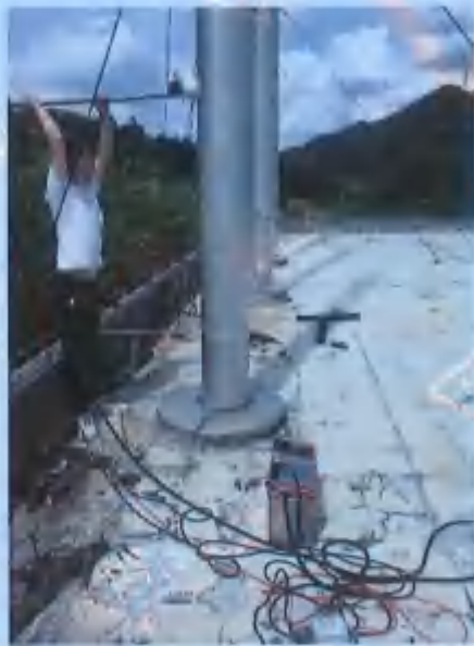
燃天然气1#锅炉排气筒
