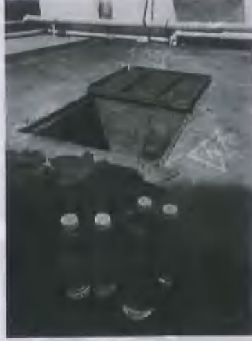
综合废水排放口
