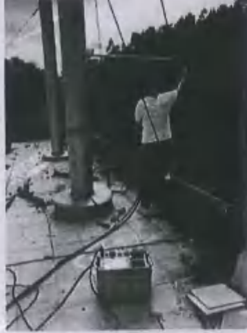
燃天然气2#锅炉排气筒
