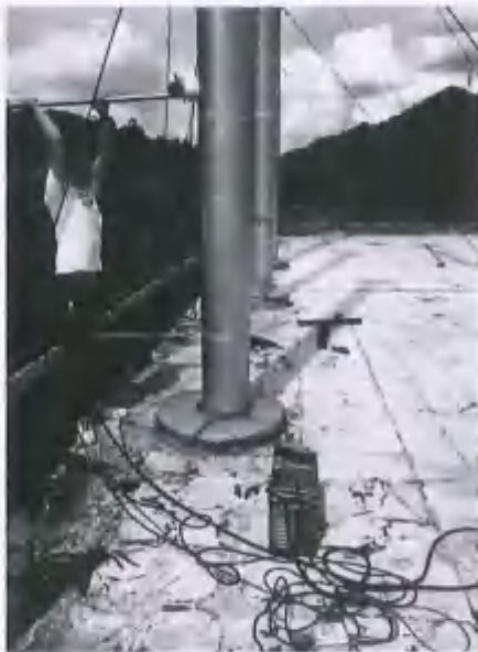
燃天然气1#锅炉排气筒
