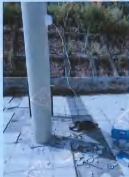
污水处理站处理后排放口
