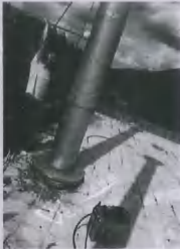
燃天然气 3#、4#锅炉排气筒
