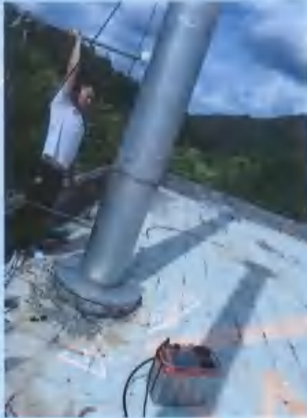
燃天然气3#、4#锅炉排气筒
