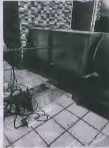
发电机废气排气筒
