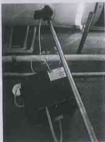
污水处理站进水处原水采样口
