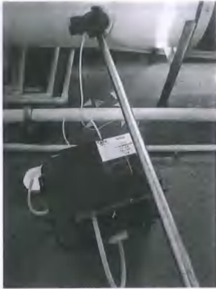
污水处理站烟囱处理前采样口
