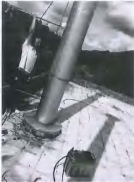
燃天然气 3#、4#锅炉排气筒
