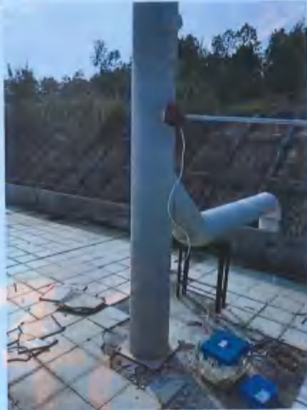
污水处理站烟囱处理后排放口
