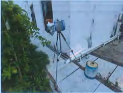
污水处理站厂界无组织下风向监控点 3#
